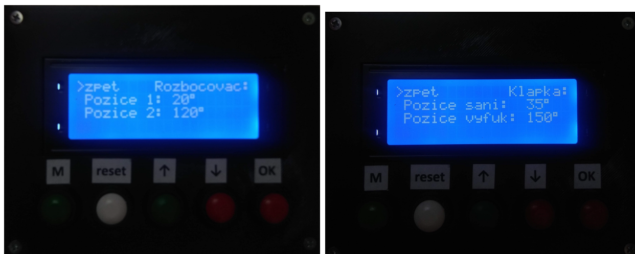
Obrázek 19: Menu pro kalibraci klapky, která mění směr proudění vzduchu v potrubní poště a pozic u rozbočovače trasy potrubní poště.
